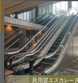
共用部エスカレーター
